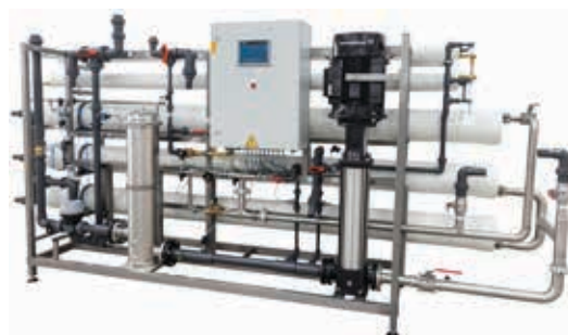
UO-S7 5000 KR/FU Controller: PLC Siemens S7 - 1200
